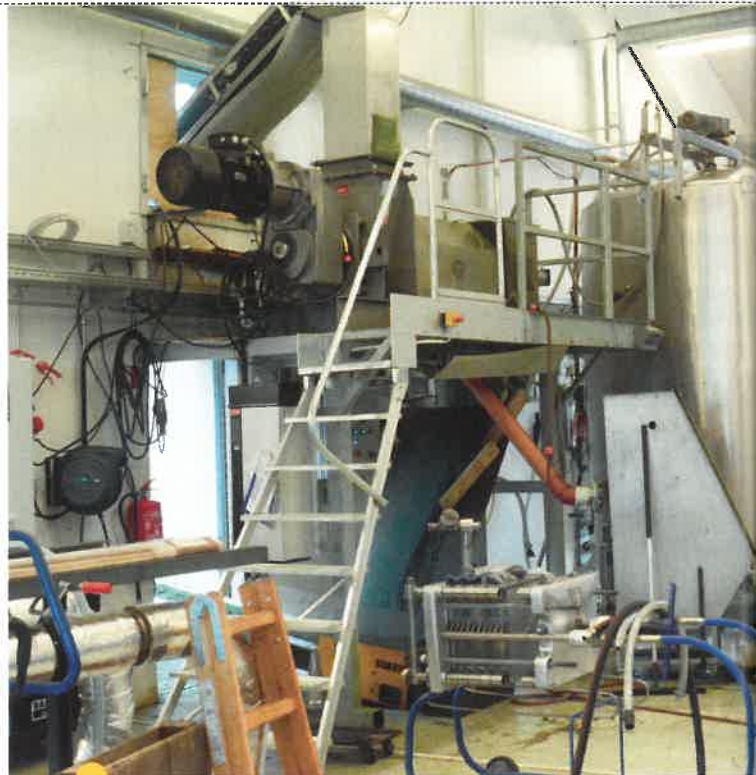
Forsøgsanlægget på Foulum har givet værdifulde erfaringer forud for etablering af demonstrationsanlægget i 2019.
